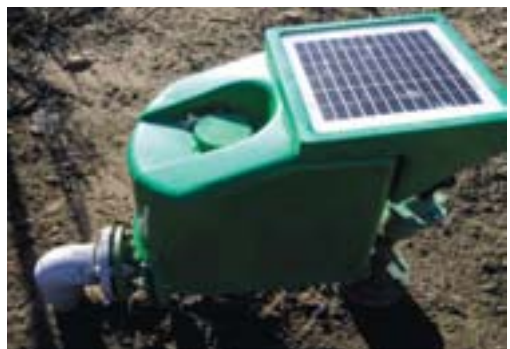
FOTO 6: Unidad conjunto hidrante – remota de telecontrol, Obra C.R. Canal del Zújar
