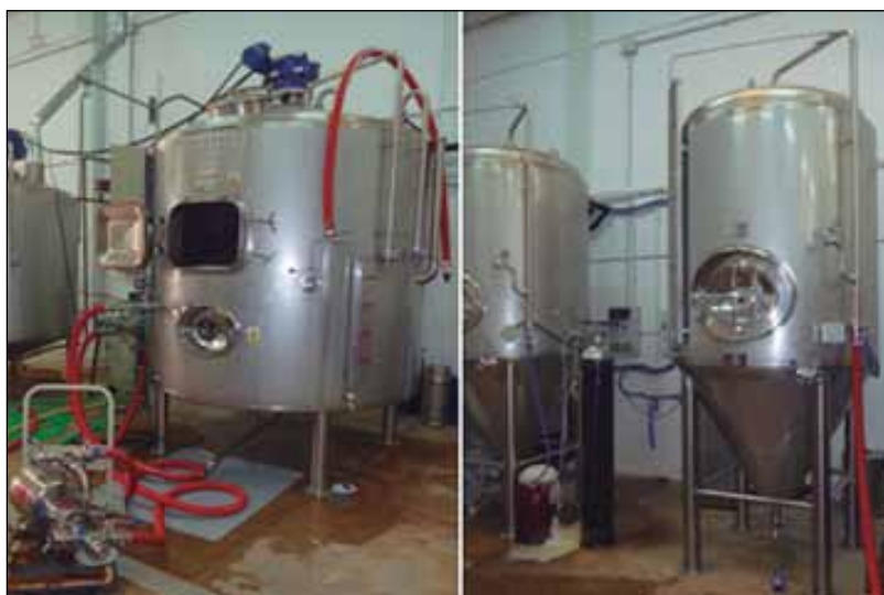
FIGURA 3: Instalaciones de la microcervecería Ballut, situada en la localidad de Badajoz
